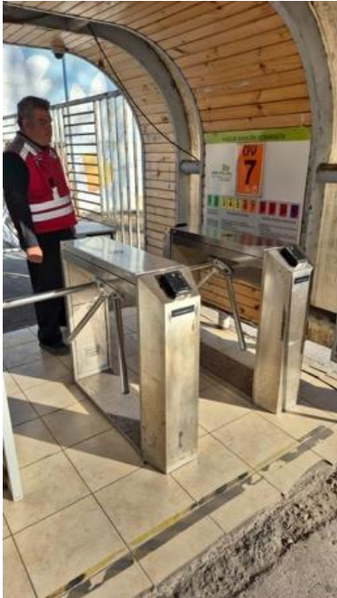
Instalación exterior – garita de acceso
