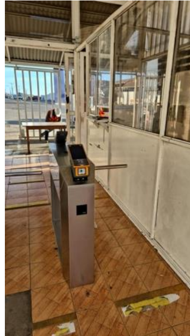
Instalación en recinto
